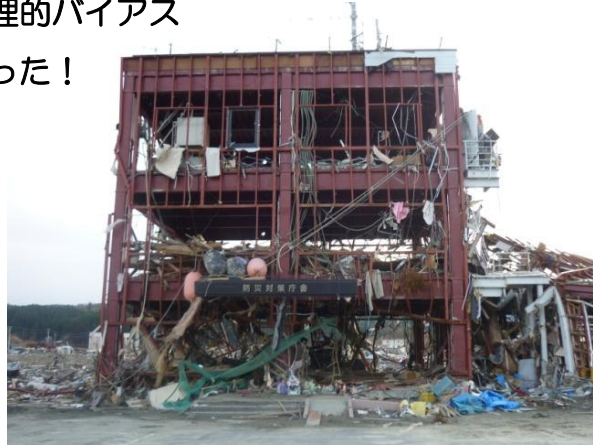
南三陸町役場・防災対策庁舎
